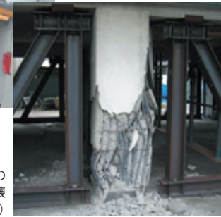
築40年の鉄筋コンクリート造の集合住宅で発生した柱のせん断破壊(福岡市)
