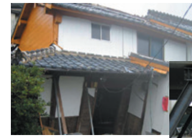
揺れにより被害を受けた家屋(玄海島)
