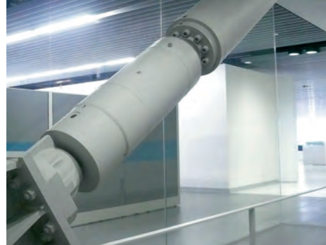
第2工場に設置された制震ダンパー。地震時にはダンパーが地震のエネルギーを吸収します
