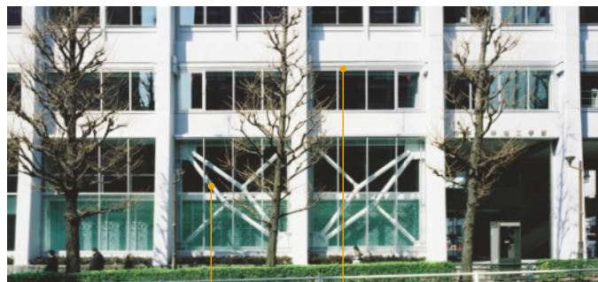
トグルダンパー 中間階免震部
