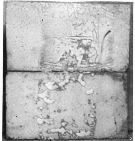
写真-3-1 酢ビ・エマルジョン接着剤の毛管水による硬化不良
