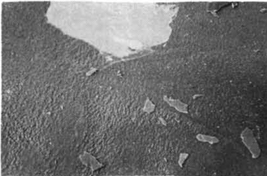
写真-5 施工1日後のポリエステル塗布の剥れ
