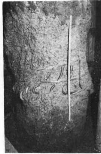
写真一3 杭体の破壊状況
