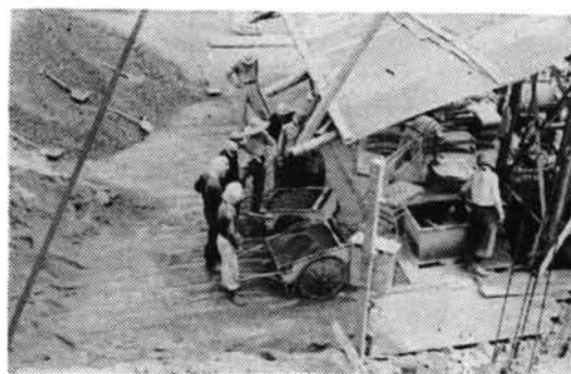
図-4 中小現場に在来よくみかけられた「コンクリートプラント」
