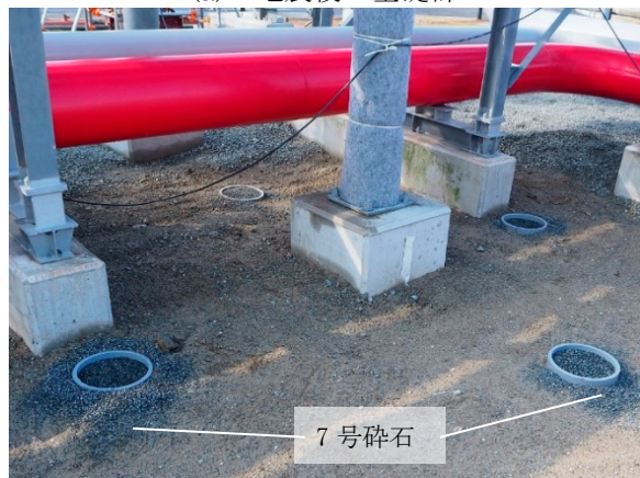
(b) φ300mmのVP管から噴出した7号砕石 写真-7 2022年地震後の配管基礎群の状況
