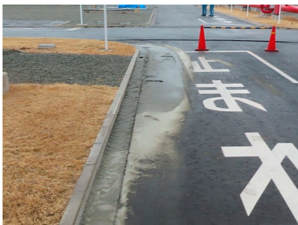
(a) L形側溝とアスファルト舗装界面からの噴砂
