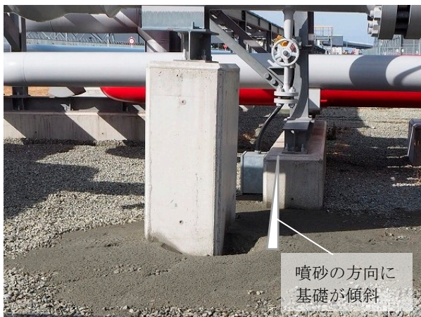
(b) 基礎界面からの噴砂状況 2
