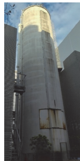
写真-1 技研たて型蓄熱槽
