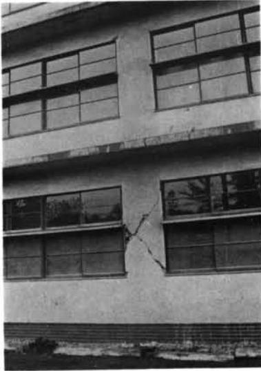
写真-2.9 八戸高校 教室側の柱のせん断ひびわれ. 傾斜とは別に, 地震による水平力を明らかに受けている.
