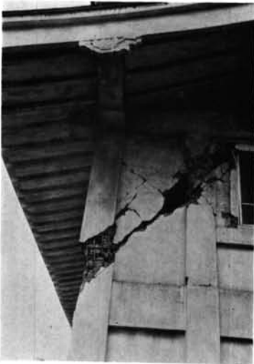
写真-2.36 来迎寺 せん断破壊を起こした隅部分のRC造角柱と耐震壁。
