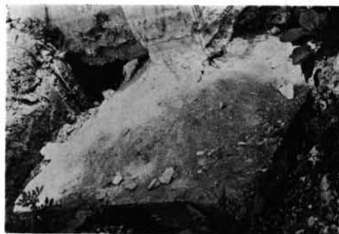
写真-2.90 函館大学 崩壊部柱基礎は健全で沈下もしていない。
