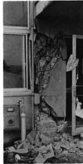
写真-2.24 八戸高専 南棟南側入口柱の被害詳細。
