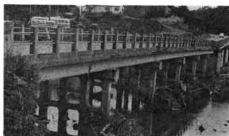
写真—3.22 七戸町付近の橋梁 橋脚の不同沈下 （昭和43年7月3日撮影）
