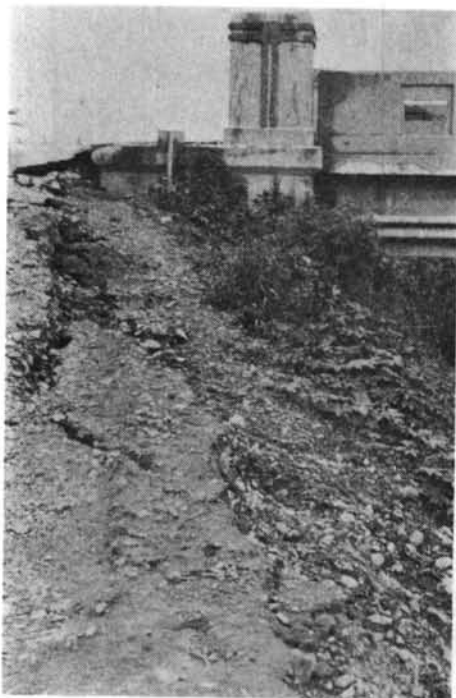
写真—3.24 奥入瀬川にかかる橋梁 端部取付道路の亀裂 （昭和43年7月3日撮影）
