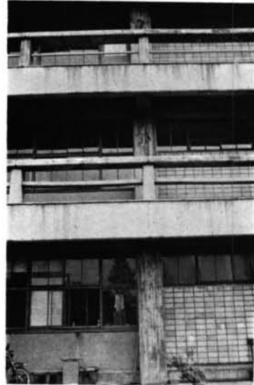
写真-2.64 野辺地高校 せん断ひびわれの状況。1階柱にひびわれがないのは、壁と柱の間に伸縮目地がとってあったからである。
