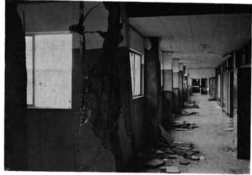
写真-2.17 八戸高専 南棟の入口から中央棟に連なる廊下. 手前の柱は入り隅柱. 繰返し振動を受けて主筋とコンクリートの付着はもはや失われているが, あばら筋が原型を維持している.
