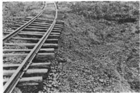
写真—3.38 南部鉄道志戸岸付近の築堤流出（昭和43年7月3日撮影）
