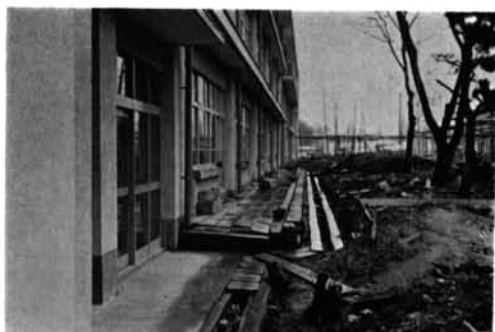
写真-2.92 五戸小学校 教室窓側。柱は無傷であるが建物周囲の埋戻土が沈下している。
