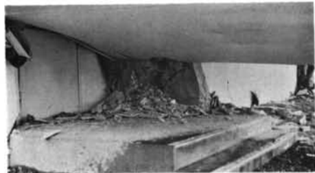
写真-2.42 三沢商高 傾斜の原因となった増築部分A通北側の1階柱の破壊状況。柱の断面は500×800、主筋は14-19φ。
