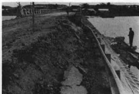
写真—3.28 鷹架橋端部取付道路の崩壊 (昭和43年7月4日撮影)
