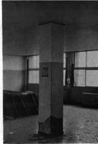
写真-2.20 八戸高専 南棟東寄部分の中柱。両外柱の破壊に伴う変形によって曲げを受けたものと思われる。なお、柱脚付近にあら筋が見当らず、主筋のかぶりも浅い。
