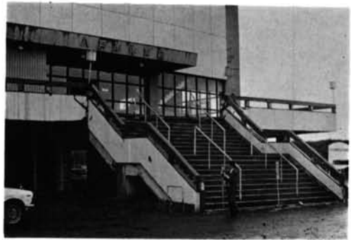
写真-2.38 八戸体育館 建物周辺地盤の沈下によってRC造階段が被害を受けている。
