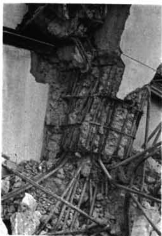
写真-2.82 函館大学 写真-2.81被害詳細。
