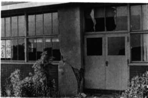
写真一2.46 三沢商高 既存棟の南側柱のせん断破壊(H通り). 右開口部の影響によってひびわれの生じ方が限定される.
