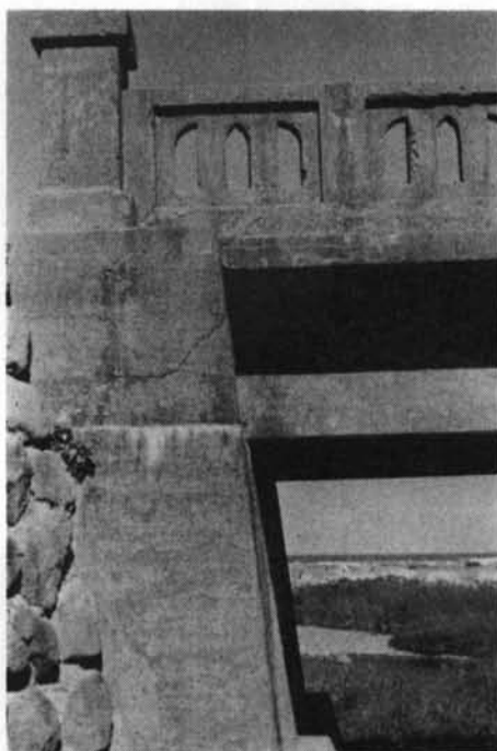
写真—3.32 老部橋橋台の亀裂 (昭昭43年7月4日撮影)
