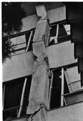
写真-2.87 函館大学 南側小柱のせん断変形.
