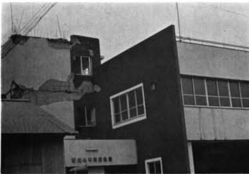
写真-2.60 野辺地町消防本部 RC造2階の建物の一部が壁構造7層の望楼になっている。建物として剛性の急変する屋階付近で望楼の壁面に水平に曲げひびわれが生じている。このひびわれ位置は2、3、4階の床面と一致しており、コンクリート打断面であろう。3階の柱は圧壊している。写真ではすでに望楼の4階以上の部分がとり除かれている。
