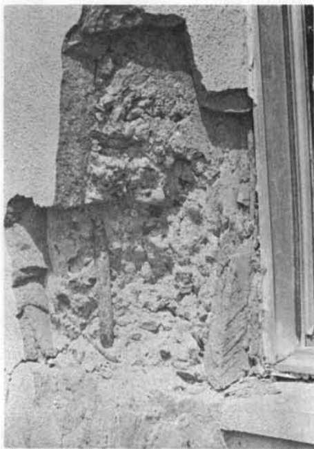
写真-6.1 骨材に死に石がみられる(八戸工業高等専門学校)
