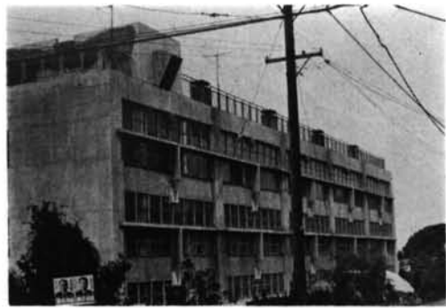
写真-2.51 岡三沢小学校 図-2.7 に示すようなプランのRC造3階の建物で、教室の廊下側外柱が1階と2階でせん断破壊を起こした。また、屋外避難階段が倒壊した。建物内部では、各階の耐震壁にせん断ひびわれが生じた箇所があり、はりにも各所に曲げひびわれがみられる。
