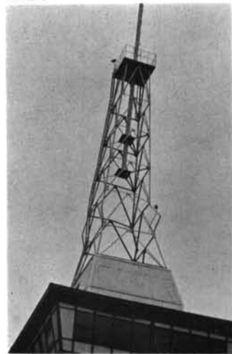
写真-2.33 八戸タワー 被害部詳細。
