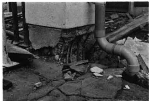
写真-2.62 野辺地中学校 ピロティ柱脚の局部破壊。施工上問題がある。
