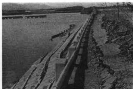
写真—3.27 鷹架橋端部取付道路の崩壊 (昭和43年7月4日撮影)
