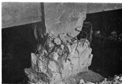
写真-2.7 八戸東高校 せん断破壊で座屈した脚柱。柱断面1,000×500。主筋25φ、22φ。
