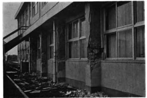
写真-2.11 八戸高専 南棟東寄部分の被害状況腰壁の剛性が高いために, 柱のその部分または柱頭の位置で曲げせん断破壊が生じている.
