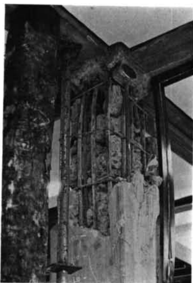
写真-2.3 八戸市立図書館 隅柱の頭部破壊状況.
