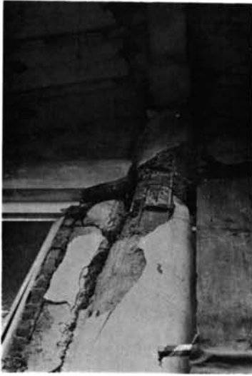
写真-2.35 来迎寺 せん断破壊を起こして被覆コンクリートが剥落した円柱。
