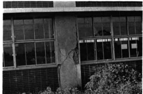
写真一2.47 三沢商高 既存棟の南側柱のせん断破壊(F通り). 斜ひびわれの先端が主筋に沿って走っている点に注意.
