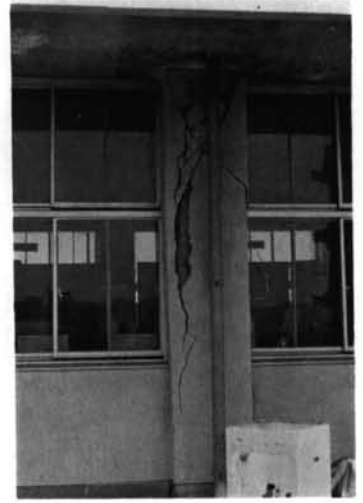
写真-2.21 八戸高専 北棟の柱。斜めひびわれの先端が主筋に沿って走っている点に注意。
