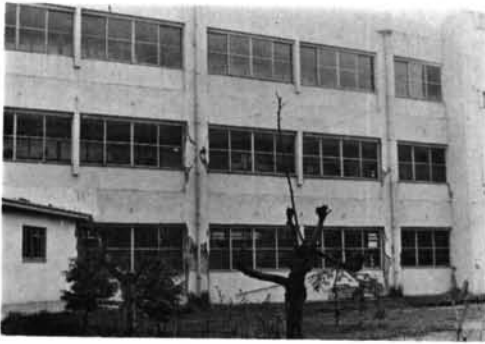
写真-2.53 岡三沢小学校 南棟の廊下側外柱のせん断破壊。腰壁の剛性が大きいためにせん断スパンが短くなり、水平力が集中した。
