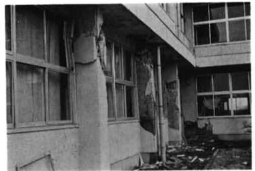
写真-2.12 八戸高専 南棟東寄部分を北側から見たところ. 写真-2.10の柱と同じせん断スパンであるが, さらに破壊の程度は大きい.
