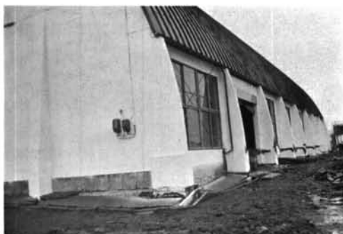
写真-2.71 三本木農協倉庫 鋼管トラスの主体構造にRC間仕切壁とブロック外壁がついた倉庫であり、周辺地盤は著るしく軟弱である。外壁や柱脚にひびわれがみられる。鉄骨ブレースは1部破断または座屈している。
