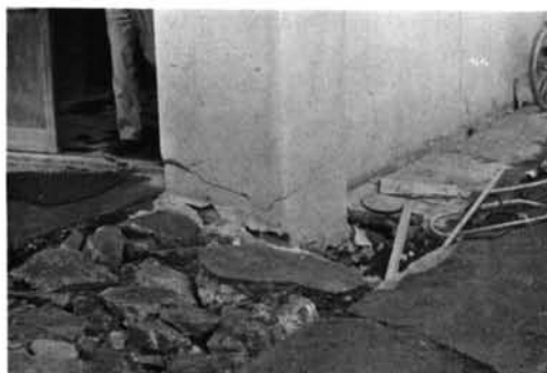
写真-2.74 十和田電鉄三本木駅 不同沈下によるRC柱脚の被害。
