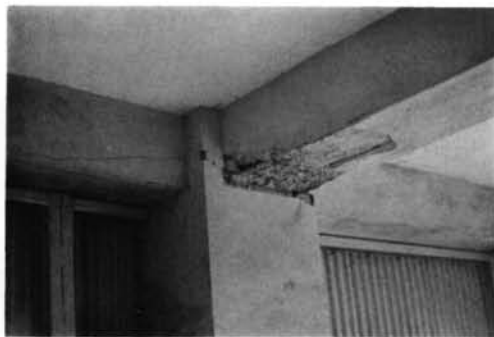
写真—2.67 野辺地高校 内部柱頭のはりに生じたひびわれ。振りを受けたようである。
