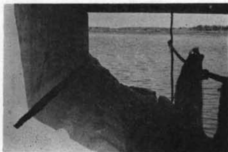
写真—3.30 尾駈橋橋台下部のり面の滑べり (昭和43年7月4日撮影)
