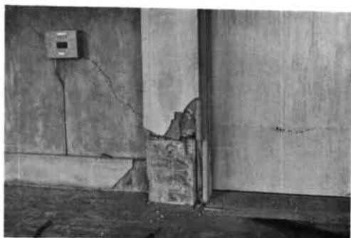
写真-2.72 三本木農協倉庫 内部RC壁のせん断ひびわれと柱脚部の被害。
