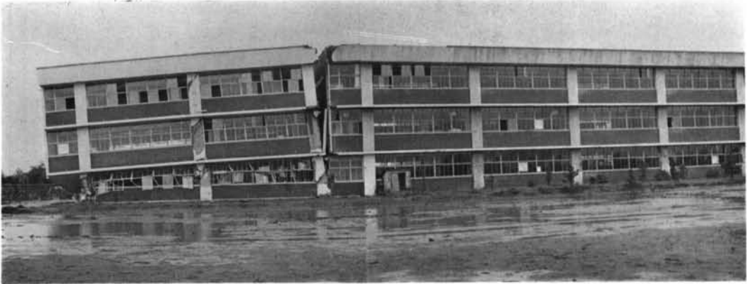
写真-2.39 三沢商業高校 図-2.6 に示すような配置の学校でRC造3階の一般教室に大きな被害があった。写真は一般教室を南側から見たところであるが、中央
