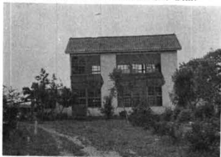
写真一6.12 仕上げモルタルの剝落(八戸市内)
