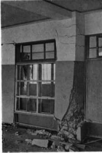
写真-2.19 八戸高専 南棟西寄部分の中柱の曲げせん断破壊。
