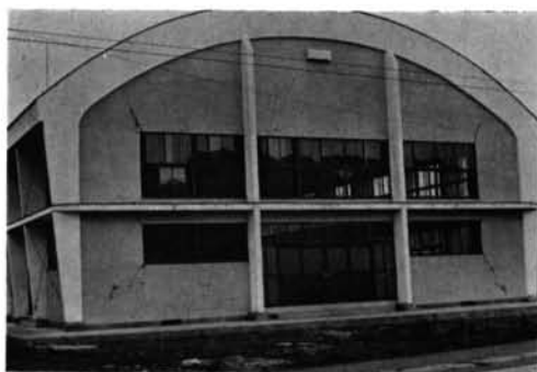
写真-2.93 巻堀小学校 震源からはかなり離れた内陸部の建物。RC造3階の校舎は仕上モルタルに微きれつがみられる程度である。この鉄骨造体育館は妻側のモルタル壁が抵抗しており、ベースプレート付近のコンクリート被覆がとれている。
