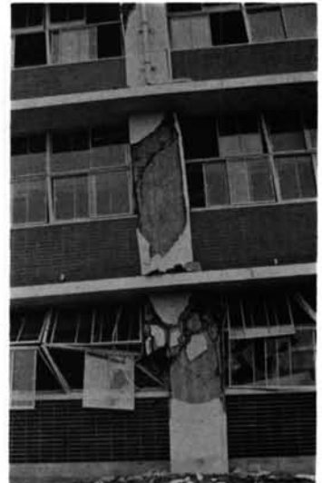
写真2.45 三沢商高 増築部分南側のB通柱の被害.
