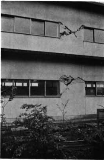
写真-2.54 上久保小学校 RC造3階の校舎の壁柱にみられるせん断破壊。
