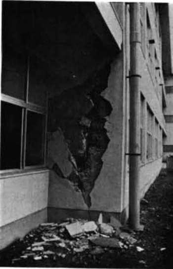
写真-2.27 八戸高専 南棟から中央棟に連なる東側部分のつなぎ壁の被害。壁の両端は柱。
