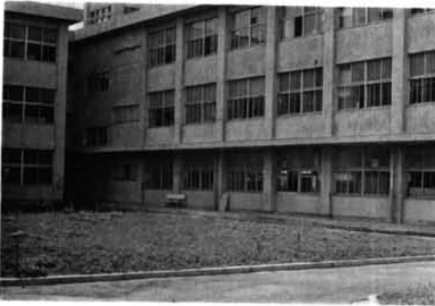
写真-2.15 八戸高専 北棟の東寄部分. 左奥の壁の多い柱がせん断破壊を起こしている. せん断スパンが短いからである.
