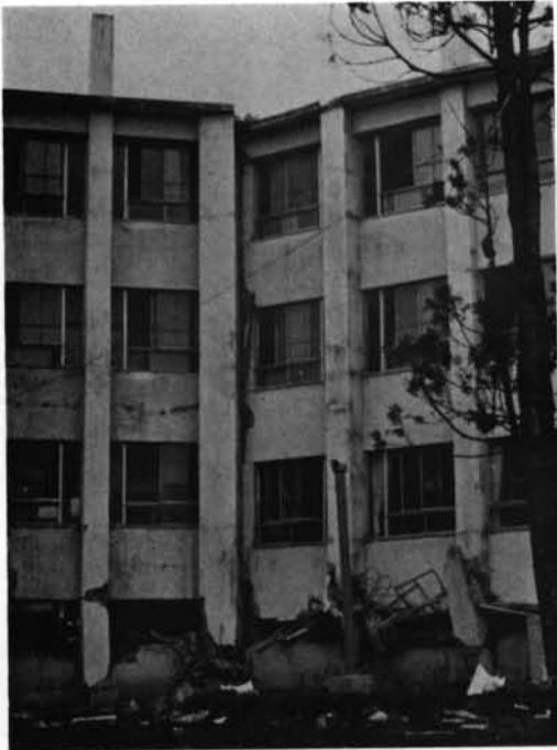
写真-2.78 函館大学 第1期と第2期工事の結合部の ずれ。
