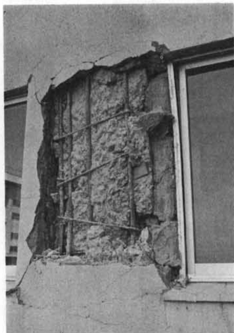
写真-6.2 柱型の中に型わくの棧木を打ち込んでしまっている(八戸工業高等専門学校)
