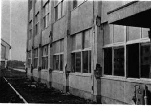
写真-2.13 八戸高専 南棟の西寄部分. 比較的せん断スパンの長い柱の曲げ破壊. 端部主筋まわりの被覆コンクリートがはく落している.
