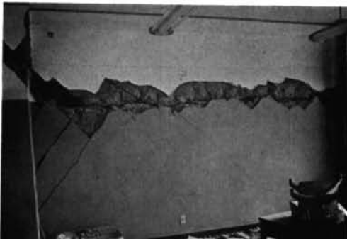
写真-2.28 八戸高専 内部RC壁の被害。
