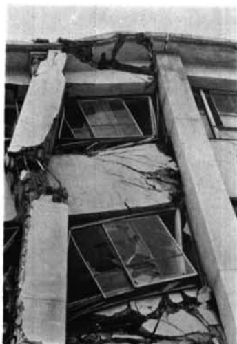
写真-2.80 函館大学 崩壊部詳細。はり柱接合部の崩壊の仕方に注意。
