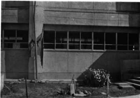
写真-2.55 昭陽小学校 せん断スパンの短い柱のせん断破壊。
