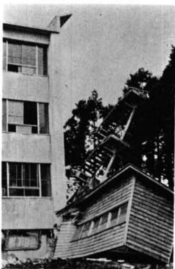
写真-2.89 函館大学 避難階段アンカーボルトの破断による倒壊。
