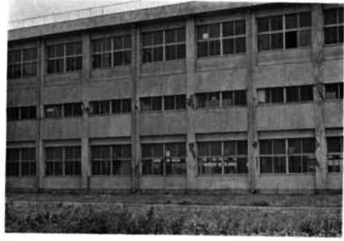
写真-2.16 八戸高専 北棟の北側. この部分だけ2階の柱にも被害が及んだ. 腰壁, 下り壁のためにせん断スパンが短くなり, 水平力が集中したからである.
