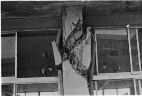
写真-2.23 八戸高専 南棟の東寄部分北側柱の被害詳細。
