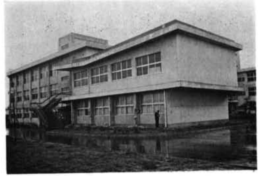
写真-2.10 八戸高等工業専門学校 RC造3階の建物で1階柱に被害が集中した. 八戸市郊外の小高い丘に位置するこの校舎は, 東西を長辺として3棟が並行にあり, 写真は最も被害の著しい南棟である. (図-2.3参照)
