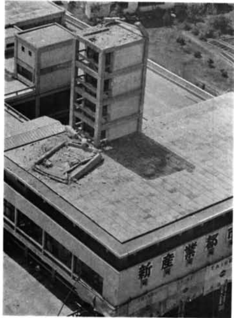
写真-2.30 八戸市役所 RC造3階の建物でペントハウスが5層ある。写真はペントハウスの壁のない最上層が崩壊して落下したところ。(読売新聞社提供)
