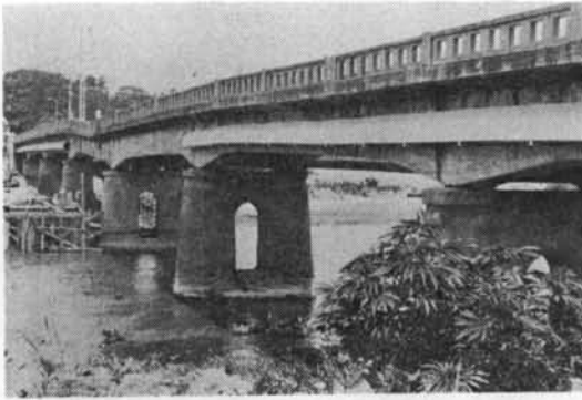
写真—3.20 尻内橋橋脚の不同沈下（昭和43年7月2日撮影）
