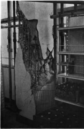
写真-2.59 上北町農協事務所 1階柱のせん断破壊を内側からみたところ。柱断面は500×600、主筋は22φで、あばら筋は9φ250@である。
