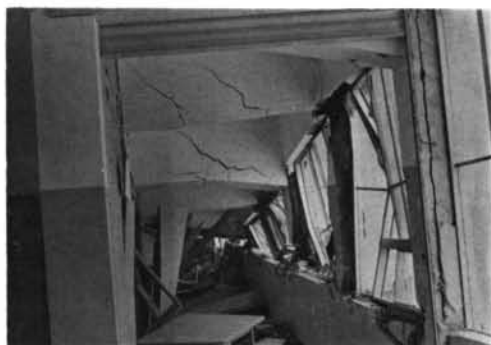
写真-2.85 函館大学 2階廊下より崩壊部をみる.
