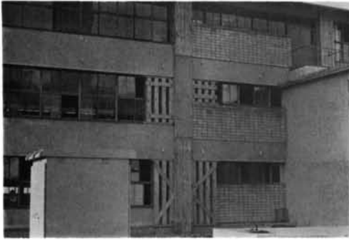
写真—2.65 野辺地高校 腰壁のついた柱のせん断ひびわれと補強状態。今回の地震によりRC造建物の受けた被害は著るしいが、その不信感のあらわれか、当面の応急処置なのか、あるいはその両方であろう。
