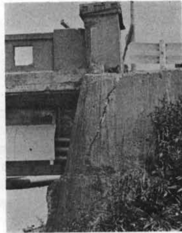
写真—3.21 尻内橋橋台の亀裂（昭和43年7月2日撮影）
