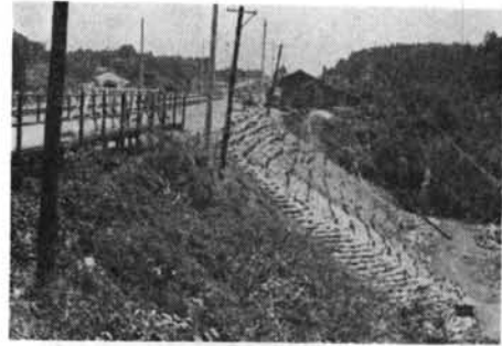
写真-3.34 東北本線小川原駅構内築堤崩壊の復旧処置 (昭和43年7月4日撮影)
