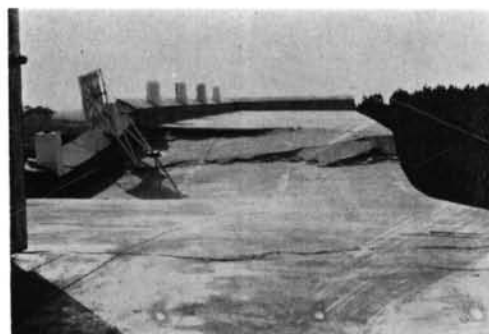
写真-2.88 函館大学 屋階スラブの崩壊.
