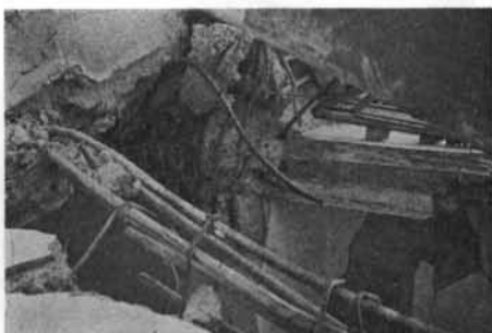
写真-6.7 ウォールガーダーの鉄筋の継手部にフックの無いものがみられる(函館大学)
