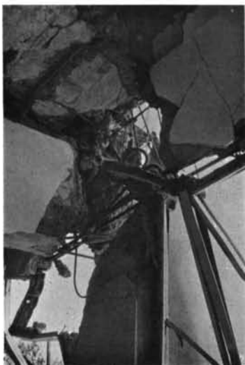
写真-2.84 函館大学 建物内部からみた柱はり接合部の破壊状況.
