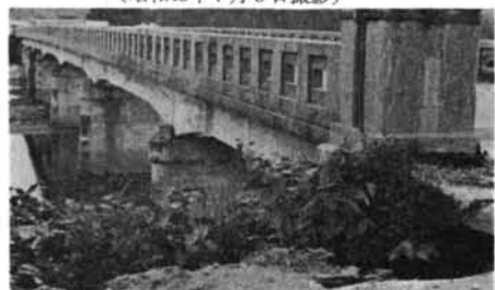
写真—3.23 奥入瀬川にかかる橋梁 端部取付道路の陥没 （昭和43年7月3日撮影）
