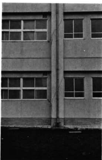
写真-2.91 五戸小学校 内陸部で被害を受けたRC造3階の建物の例である。せん断スパンが付随壁のために小さくなって剛性が高くなり、水平力が集中した。
