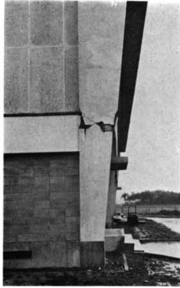
写真-2.29 八戸高専 鉄骨造体育館. 剛性の急変する箇所に見られる典型的な被害。
