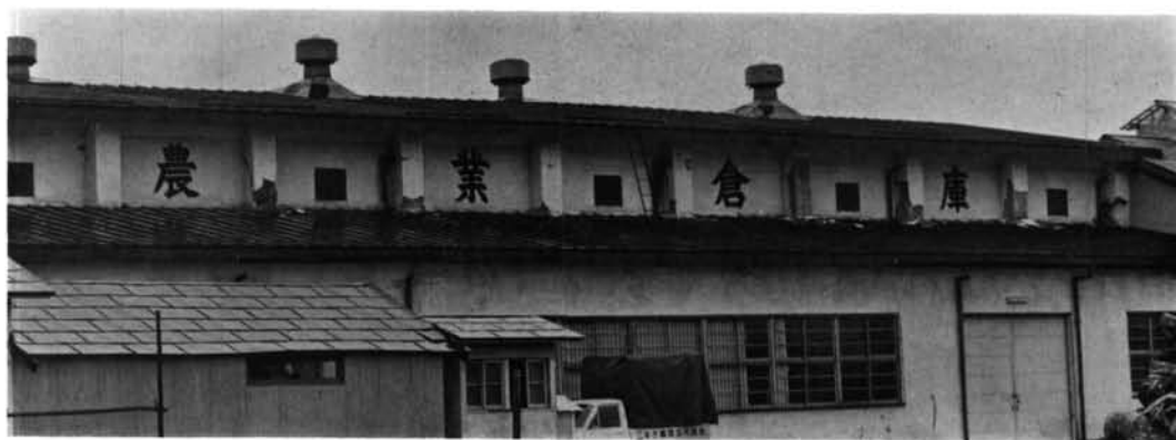
写真-2.70 三本木農協倉庫 主体はRC造1階で短辺1スパンで12mある。短辺方向に柱頭、柱脚で曲げひびわれが生じ、鉄骨小屋組などの拘束で写真に見るように
