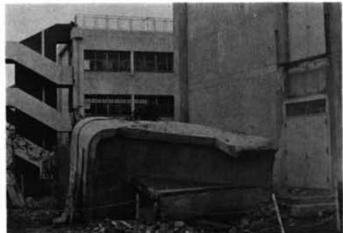
写真-2.52 岡三沢小学校 北棟の倒壊した屋外避難階段。この階段は厚さ18cmの壁で自立しているが、教室棟と構造的には十分結合されていない。
