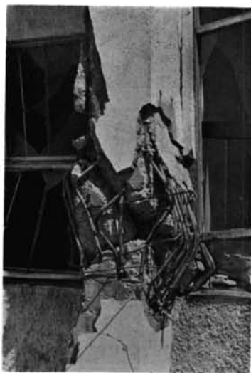
写真-2.83 函館大学 東端部階段室1階柱のせん断破壊。
