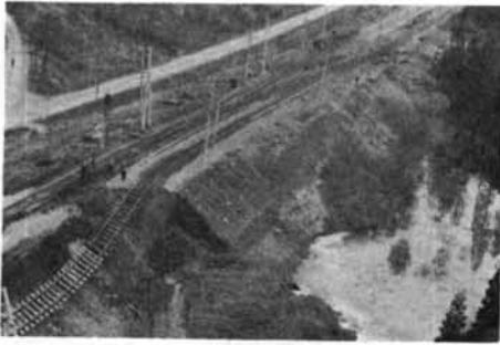
写真-3.33 小川原駅構内築堤の大崩壊 (盛岡鉄道管理局総務部撮影)
