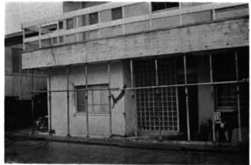
写真-2.58 上北町農協事務所 1階柱のせん断破壊。
