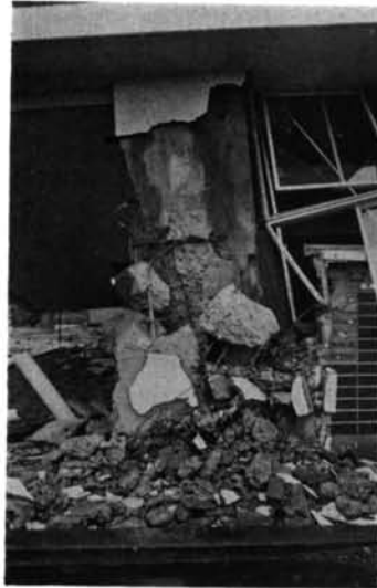
写真一2.44 三沢商高 増築部分A 通南側柱の破壊状況. B通柱と同様に地震力と傾斜による両方のせん断破壊が認められる. 柱の断面は 500×800, 主筋は12—19φ.
