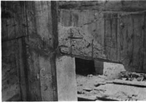
写真-2.8 八戸東高校 脚柱つなぎはりの不用意な端部配筋.
