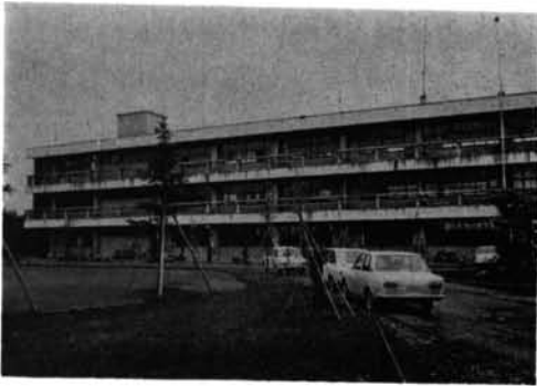
写真-2.63 野辺地高校 長辺スパンが7.8mで10スパン、短辺が1スパンだけで7.2m(2.4mの張出し)のRC造3階の建物が2棟ある。写真の左方にみえるタイル張り腰壁のために、その壁に付く柱のせん断スパンが短くなって剛性が高くなり、水平力が集中してひびわれが生じている。(図-2.8参照)
