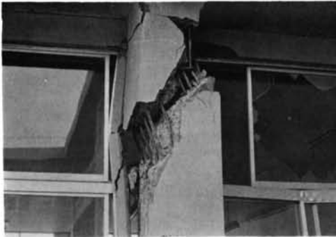
写真-2.22 八戸高専 南棟の東寄部分北側柱の被害詳細。
