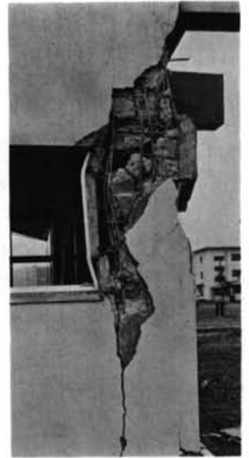
写真-2.25 八戸高専 南棟西北隅柱の被害詳細。
