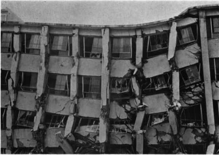
写真-2.77 函館大学 M7.5の余震を受けて後の状況。 本震直後の写真と比較されたい。
