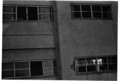
写真-2.56 七百小学校 柱の両側にある壁が大きく偏心しており、またこの柱の内部側面には縦にひびわれが生じている点に特徴がある。
