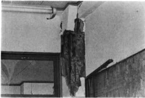
写真—2.66 野辺地高校 内部柱頭の破壊状況。隅角部の施工の悪さが目につく。
