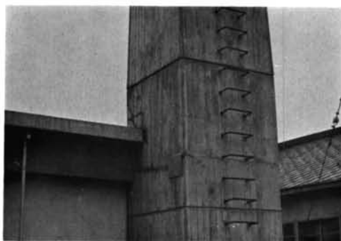
写真-2.73 北里大学 RC造煙突で剛性の急変する箇所に曲げひびわれが生じている。
