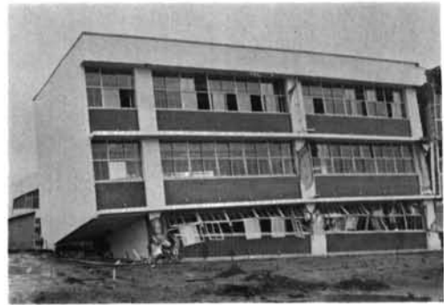
写真-2.40 三沢商高 一般教室は長辺スパンが9mで8スパンあり、短辺は1スパンだけで7.5mで、さらに北側へ廊下部分として2.5mの張出しがある。左端の奥の1階柱がせん断破壊を起こして座屈しており、建物は左奥に傾斜した。
