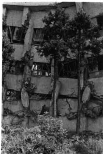
写真-2.81 函館大学 南側崩壊部。1, 2階が完全につぶれており、大柱の鉄筋が大きくはらんでいる。
