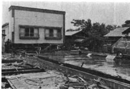
写真一6.15 軽量鉄骨の梁と木製柱とのジョイント部が破壊(三本木市内)
