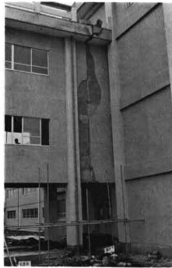
写真-2.61 野辺地中学校 コ字形建物の隅角部伸縮ジョイント付近の被害。モルタル仕上げとひさしの一部を痛めただけで構造体に直接被害は及んでいない。
