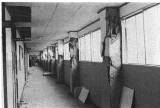
真写二 八戸高専の被害状況（屋内）
