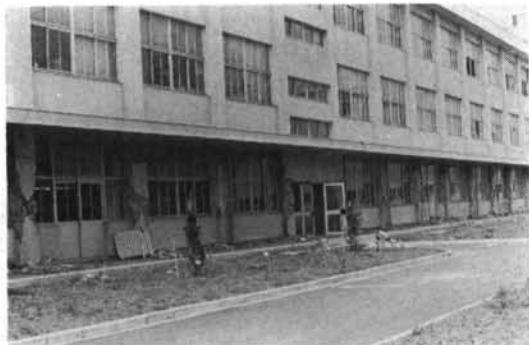
真写一 八戸高専の被害状況（屋外）
