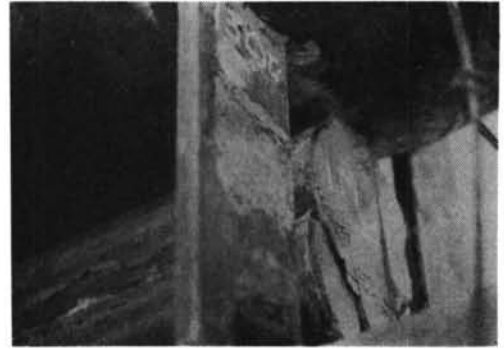
写真-6 1M破壊状況
