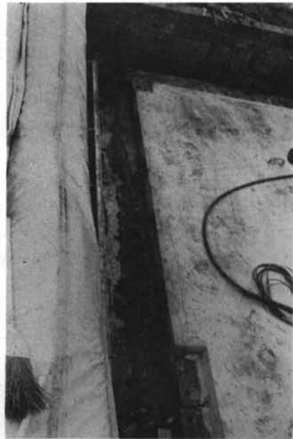
写真-12 コッター部収縮亀裂
