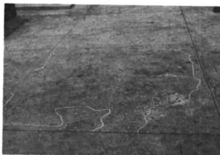
写真-1 保護モルタルの浮き(K製菜屋上, 東京) (目地と白線の間が浮いている)
