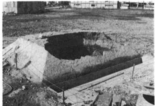
写真-2 溝壁崩壊によって生じた盛土の破壊面（ h=4.48 m）
