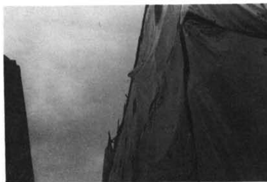
写真-7 突起物によるシートの破損
