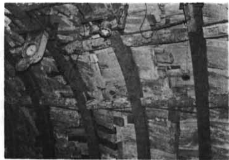
写真一4 縫地矢板矢尻部の破損状況とクラウン部軸力計の設置状況
