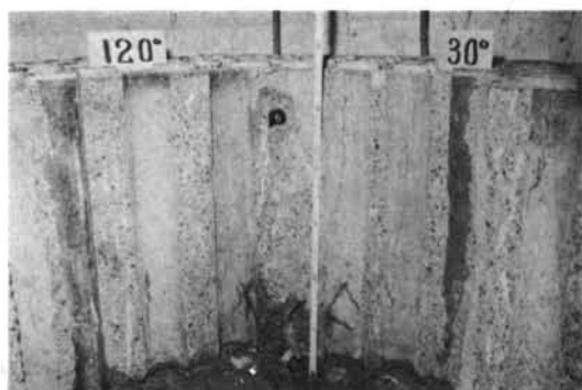
写真一18 トップスラブきれつ
