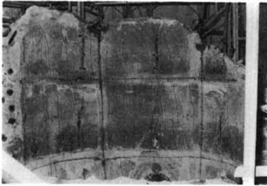
写真-19 側壁内面きれつ
