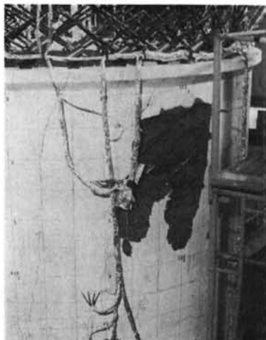
写真-15 剥落箇所
