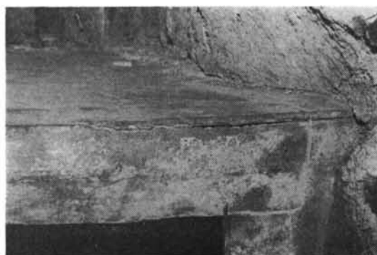
写真一16 ライナ破損部
