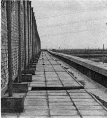
(b) 屋上南側④通りから⑬通りへ （パラベットの笠石が波うっている）
