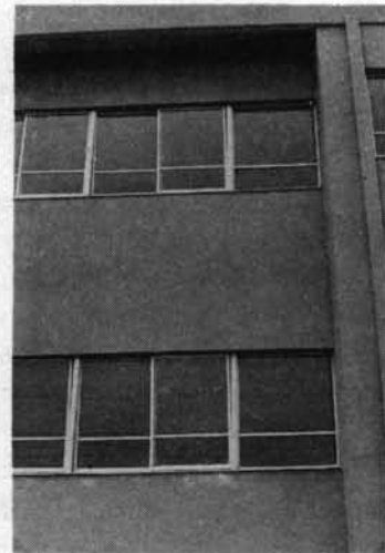
写真一 6 北側廊下の連続窓の変形状況
