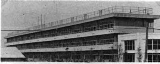
(a) 南面全景（ベランダが大きく波うっている）
