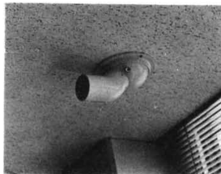
写真二 室内吹出ノズル
