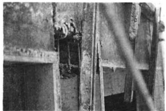
写真-2 梁筋の閉塞作用によって生じた未充填箇所(RC造)
