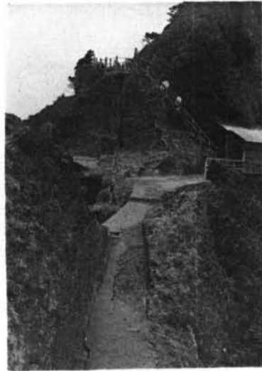
写真-7 石廊崎の岬付近にみられる地割れ
