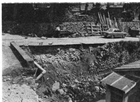
写真-1 入間、砂の盛土を石垣を擁壁として抑えてあり、地震によって、石垣がゆるみ砂が流出した。
