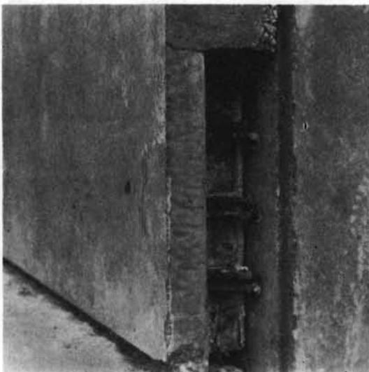
写一35 壁のL型接合部詳細。この鉄筋の位置のずれは組立て時の曲りによるもので、溶接時には楽に矯正できた。
