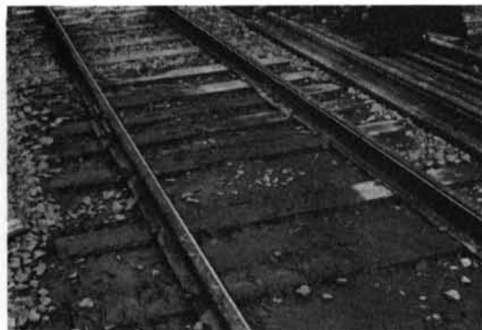
写真-1 噴泥を生じた状況
