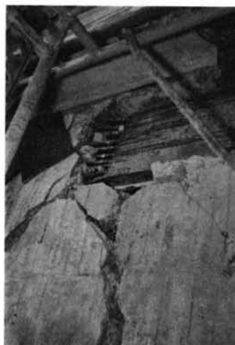
写真—2 4階円周方向壁のせん断破壊(ボックス回りの補強が充分でなかったことから被害がひどくなったようである)
