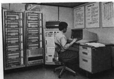
写真一 ACRUSS システム
