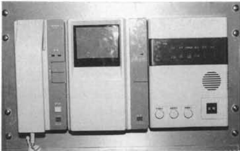
写真-6 ホームコントローラ
