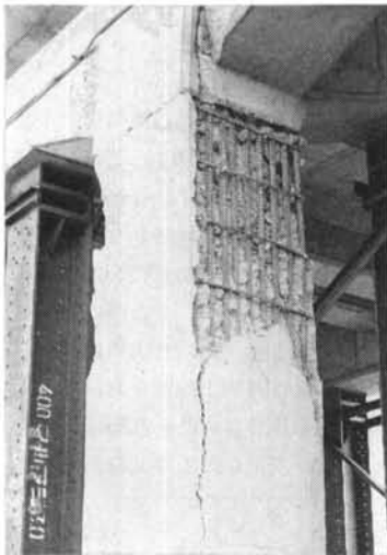
写真一八 水深第1高架橋 RC 橋脚上端部のせん断破壊
