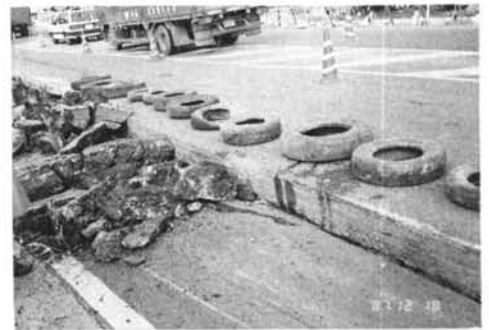
写真-6 国道126号線東金市台方地先の路面の陥没
