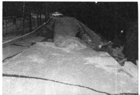
写真-2 長南中学校の盛土斜面における法層の崩壊
