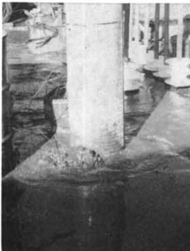
写真-1 電柱脇からの噴砂中の状況 (A工場より提供)
