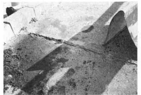
写真-7 国道126号線東金市台方跨線橋取付部の段差
