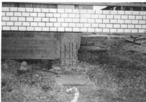
写真一〇 長南中央公民館基礎梁下面の RC 柱のせん断破壊
