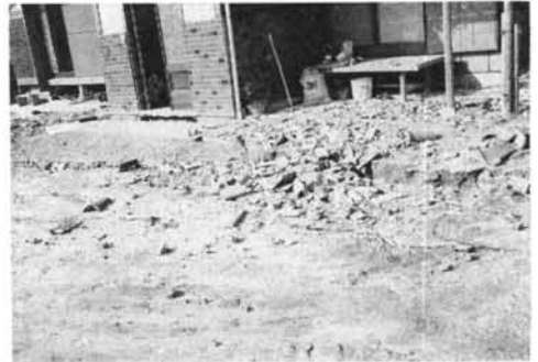
写真-5 国道126号線東金市山田の斜面崩壊による家屋の損傷
