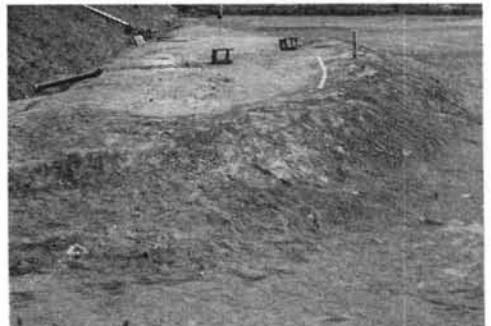
写真-3 長南中学校の盛土斜面における法尻の隆起
