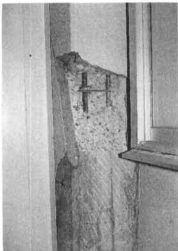
写真一九 長南中学校校舎の RC 柱のせん断ひび割れ
