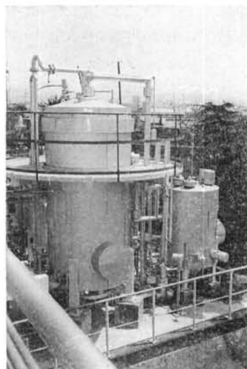
写真-1 ペンチプラントの概観
