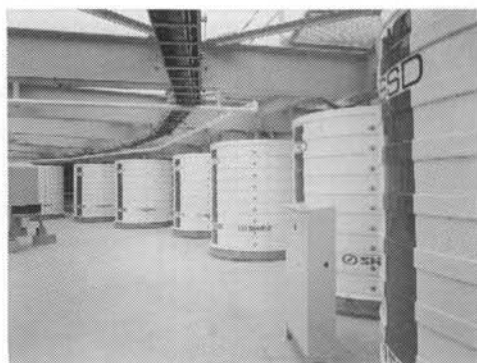
写真-2 TLD の設置状況
