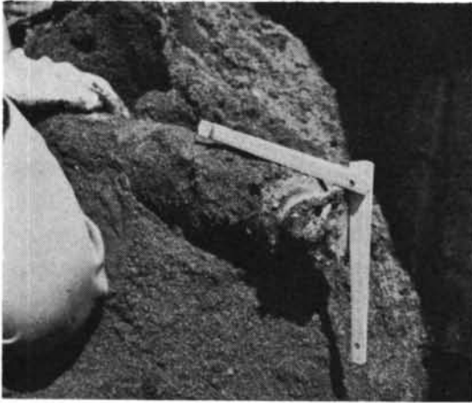
写真一5 モルタル打設実験：くい先端は細くなり、そのくびれた個所にゲル化物が溜まっている。
