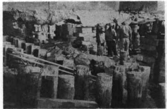
写真-1 松ぐいの傾斜状況
