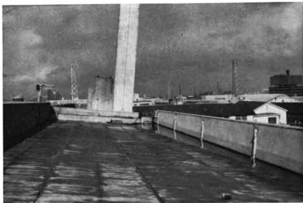
屋上に設けたウォーターレベル
