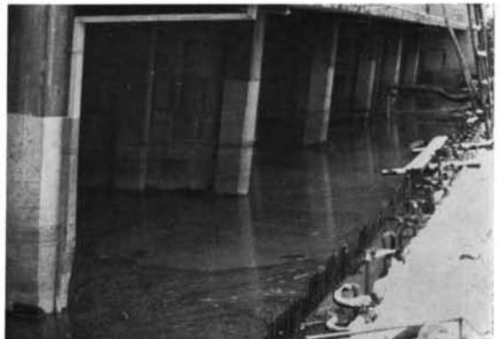
男子寮の沈下、傾斜の状況
