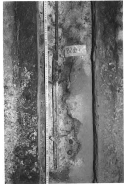
写真-2 鉄筋腐食状況(B開口側壁2角落し部)
