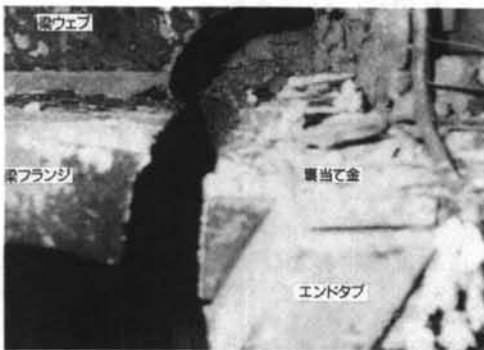
写真-2 梁端下フランジの母材破断 (建物B-TYPE-F, スカラップ端部が起点となっている)
