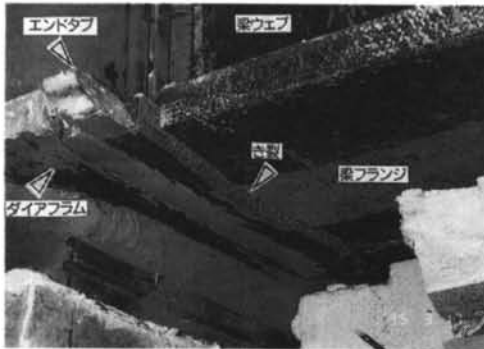
写真-1 梁端下フランジの母材破断 (建物B-TYPE-F)
