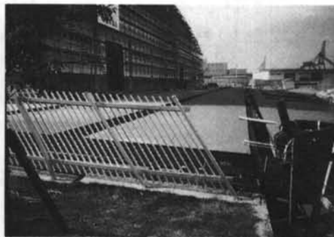
写真-4 傾いた手すり
