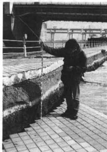
写真-3 ケーソン背面の沈下
