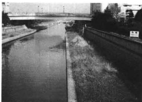
写真-5 河川堤防の側方変位
