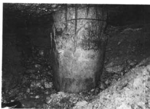
写真-6 杭頭の被害
