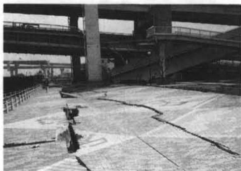
写真-2 プラットホームのひび割れ
