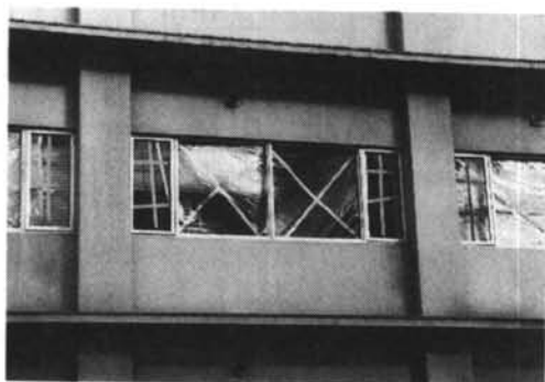
写真一 5 はめ殺し窓の被害（芦屋市）はめ殺し窓のガラスの破損
