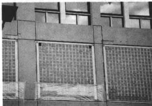
写真一8 ガラスブロックの被害(西宮市) 上部隅角部と下部のガラスブロックの破損・タイルの剥落
