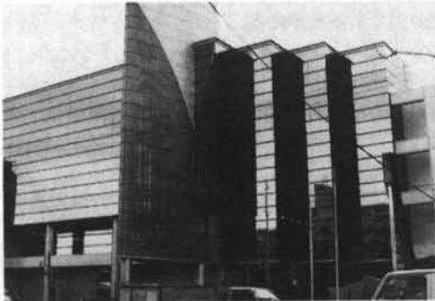
写真一7 無被害のSSG構法の状況(神戸市東灘区) 1階では被害が生じていたが、2階以上のSSG構法は無被害
