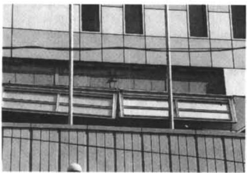
写真一 3 金属カーテンウォールの被害（神戸市東灘区）カーテンウォール部材の外れ・脱落
