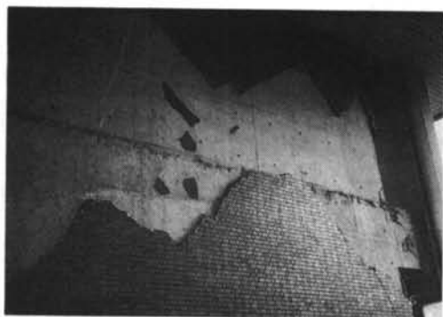
写真一18 タイル貼りの被害（西宮市）下地コンクリート面からの大面積の剥落
