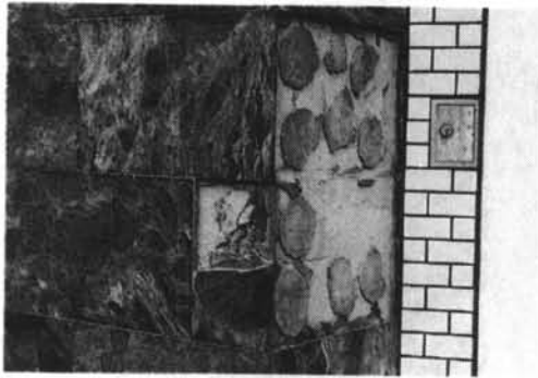
写真一13 湿式石貼り構法の被害(尼崎市)だんご貼りにした大理石の剥落
