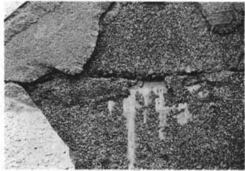
写真-16 吹付け仕上RC系外壁の被害（神戸市東灘区）コンクリート打ち継ぎ部における軽量モルタルの剥落
