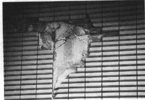
写真-17 タイル貼りの被害（神戸市東灘区）下地モルタル、貼付けモルタルおよびタイル裏足のそれぞれが破壊している状況
