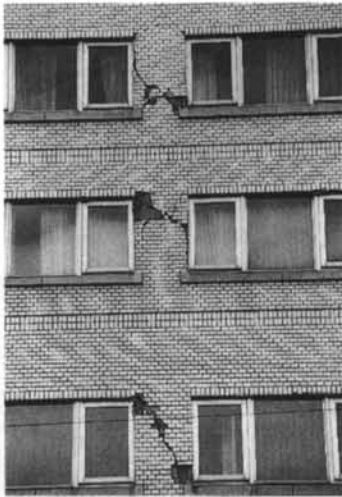
写真-14 タイル貼りの被害（芦屋市）雑壁のせん断ひび割れによるタイルの剥落
