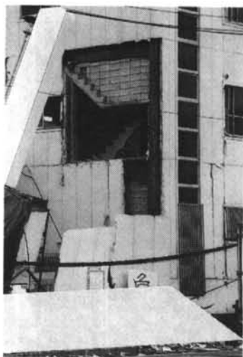
写真一21 ALCパネルの被害（神戸市東灘区）ALCパネルの脱落
