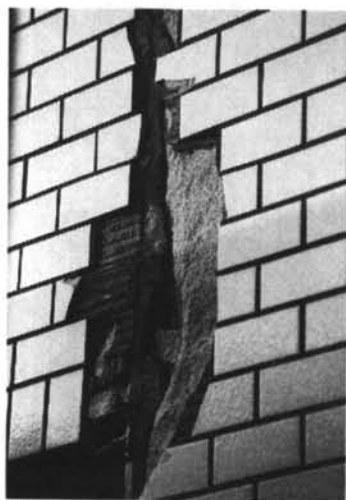
写真一22 ALCパネルタイル貼りの被害（尼崎市）ALCパネル目地部の割れ、タイル落下
