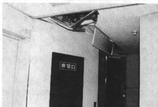
写真-4 天井の破損による防火戸の閉鎖不良
