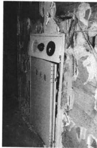
写真-2 壁の破損による室内消火栓ボックスの開閉不良
