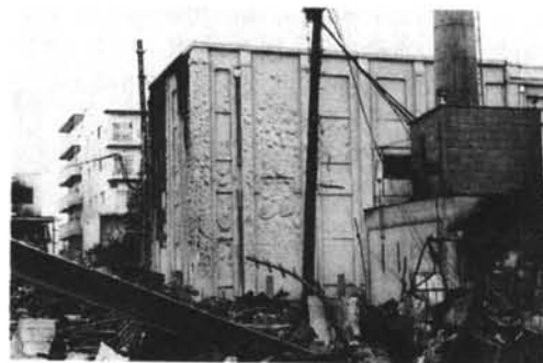
写真-1 延焼側に開口部のないRC造の残存建築物
