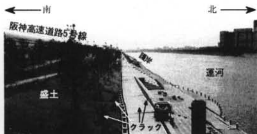
写真-1 1995 年阪神大震災による盛土および護岸部の被害状況 (南芦屋浜) (地震から3ヶ月後の撮影)
