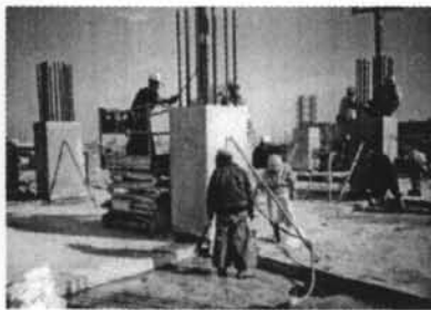
① 墨出し 柱ユニコラム型枠建込み 柱コンクリートの打設
