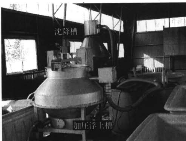
写真-1 装置の全景
