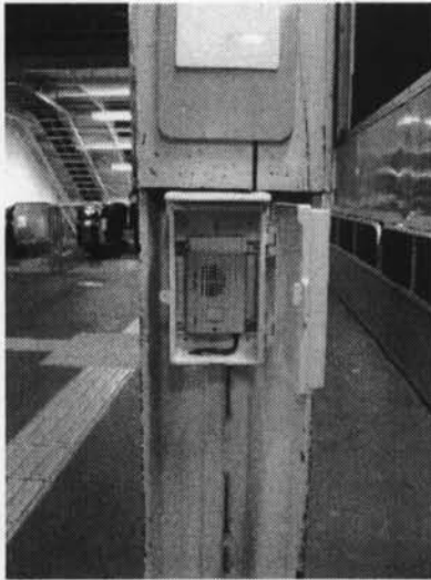
王子駅の駅員呼出しインターホン
