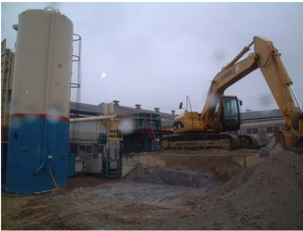
写真 - 7 HB ソイル製造プラント
