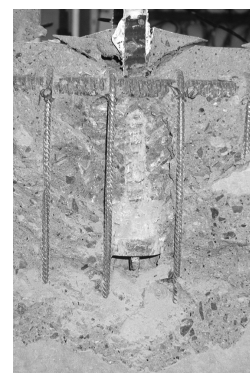
写真－3 ヘッド部破壊状況
