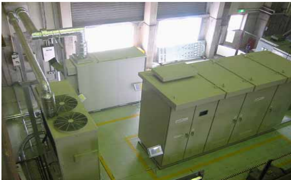
写真 - 2 大型実験棟への MGT (奥)、GE (左)、BTR (右) の設置状況
