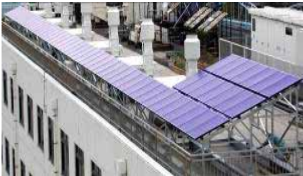
写真 - 3 中央実験棟屋上の太陽光発電装置
