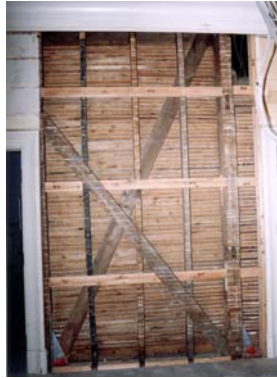
写真-11 既存筋違
