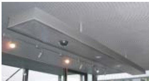
図 - 6 センサー・カメラ等機器を設置した天井ラック
