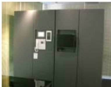
図 - 7 各住戸サーバー・管理サーバーを納めたラック
