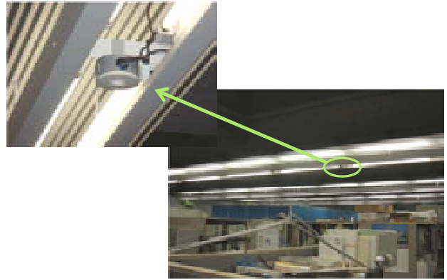
写真-2 人感センサ設置状況
