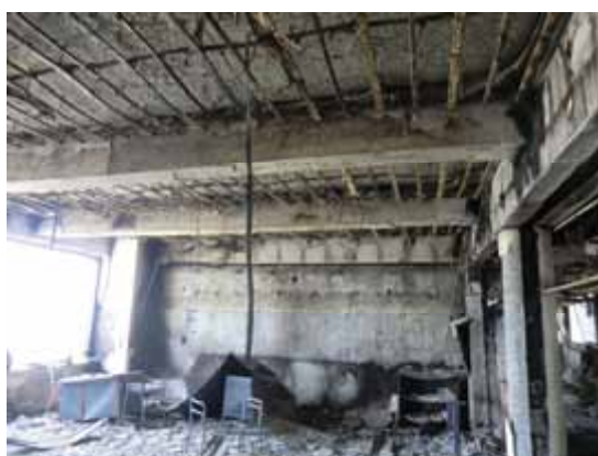
写真－5 教室間の壁(左：南側窓側、右：廊下側)
