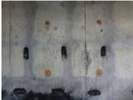
写真-14 3階6-2教室東側壁面_爆裂部拡大
