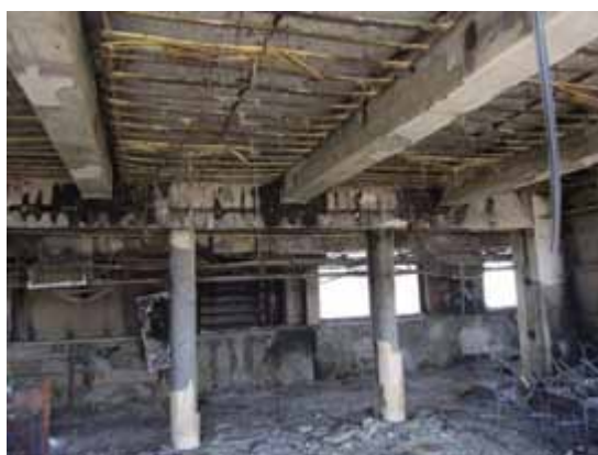
写真－6 2階普通教室と廊下間の壁の焼失
