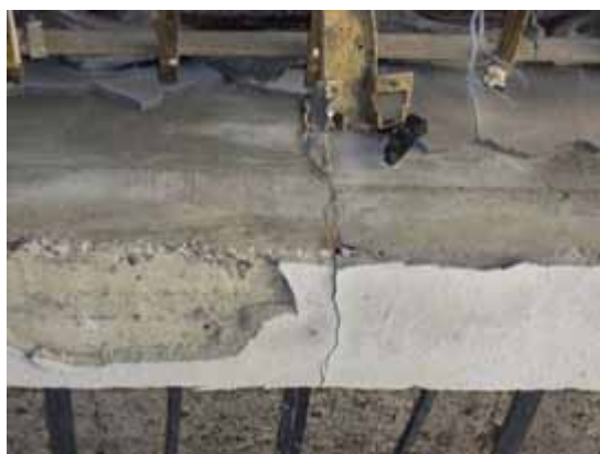
写真－4 2階普通教室(火害度III～IV)の梁
