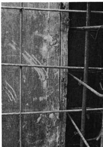
写真一31 大パネルはこのようにコーナー部分から傷み始める せき板の小口がはがれ始めている
