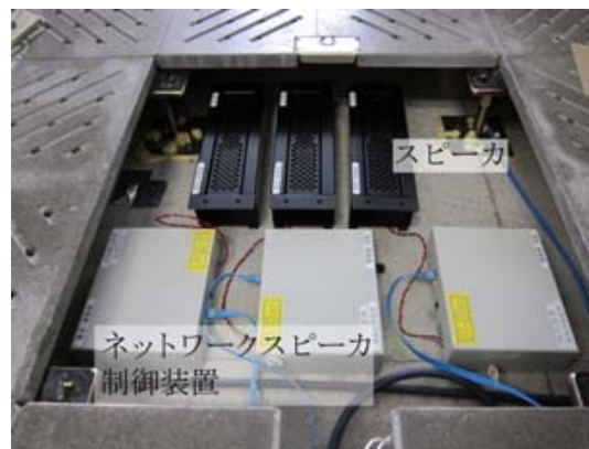
図 - 6 制御装置、スピーカの OA 床下設置状況
